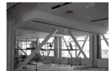
◀本館1階に設置された鉄骨ブレース
