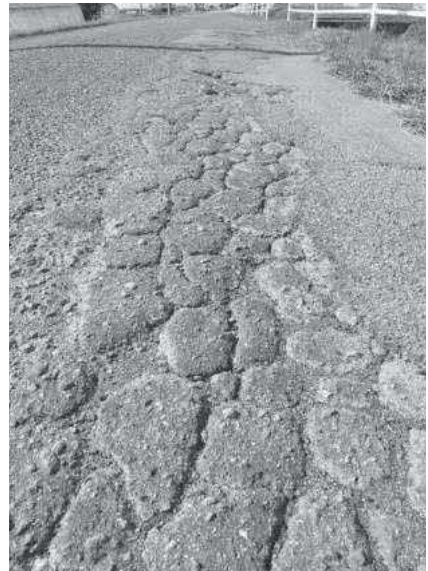
傷みの激しい町道
