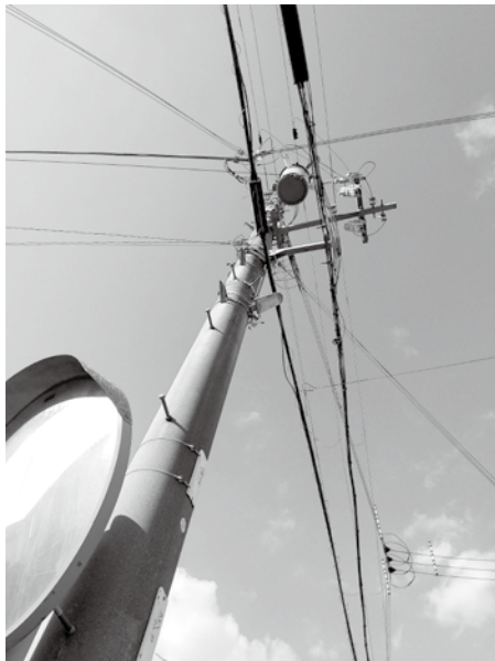
相の山に設置されている街灯
