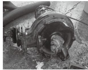
異物流入によるポンプ故障 (写真はタオル)
