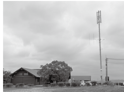
防災行政無線の拡声器 (加古大池活用施設にて)
